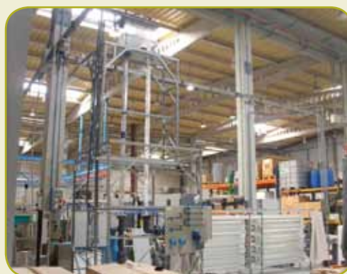
Figure 27. Vue générale de l'installation.
