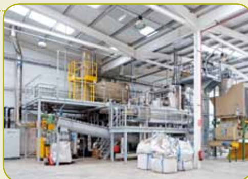
Figure 18. Vue générale de l'équipement de torréfaction. Source: CENER
